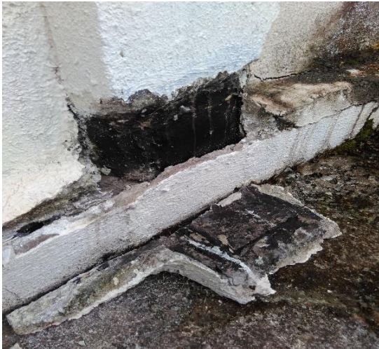
Foto 22 – Destacamento do reboco do pilar
