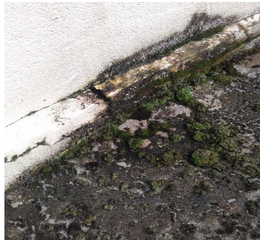
Foto 19 – Detalhe da formação de fungos na estrutura
