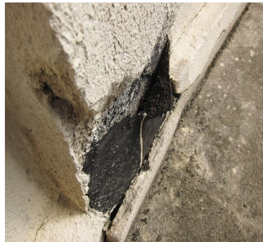
Foto 23 – Descolamento da manta impermeabilizante do pilar
