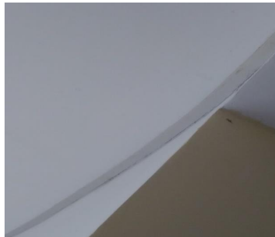
Foto 37 – Descolamento do gesso abaixo da estrutura
