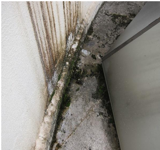
Foto 18 – Formação de fungos na estrutura
