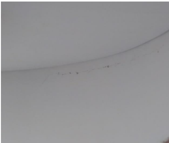
Foto 36 – Formação de fissuras abaixo da estrutura
